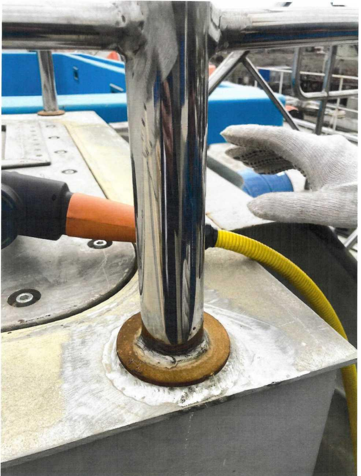
Фото 5. Исходное состояние биметаллических пластин оснований леерных ограждений;
