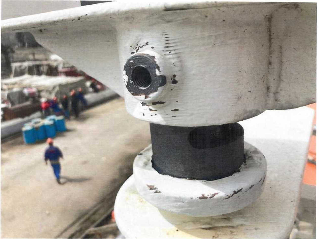
Фото 16. Результат очистки конструкции от загрязнения. Материал Ст3. Загрязнение ржавчиной, в том числе резьбового соединения, также двухкомпонентный эпоксидный ЛКМ, поражённый ржавчиной.
