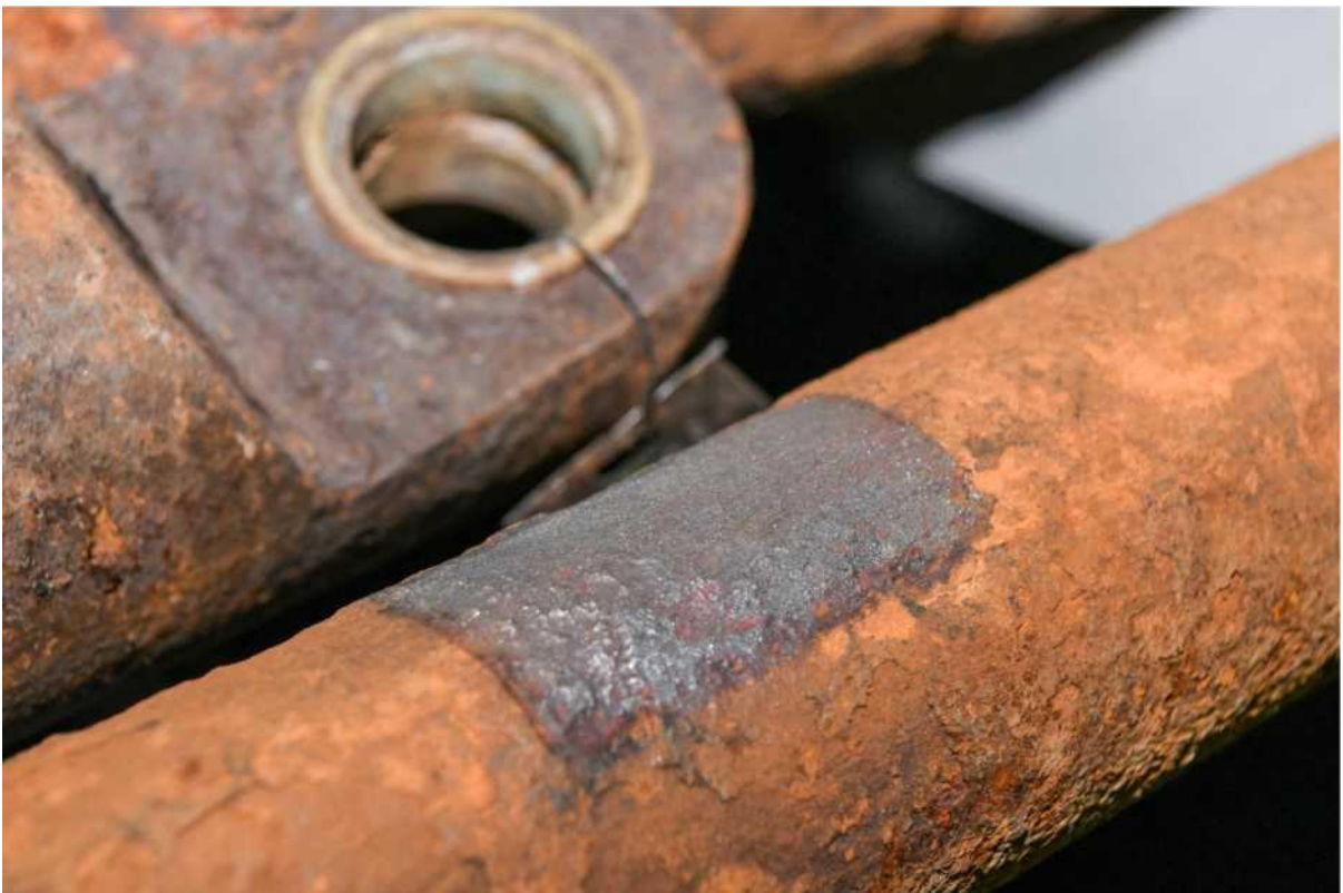
Фото 14. Результат очистки образца - Тяга привода. Обрабатываемая поверхность - язвенная коррозия.
